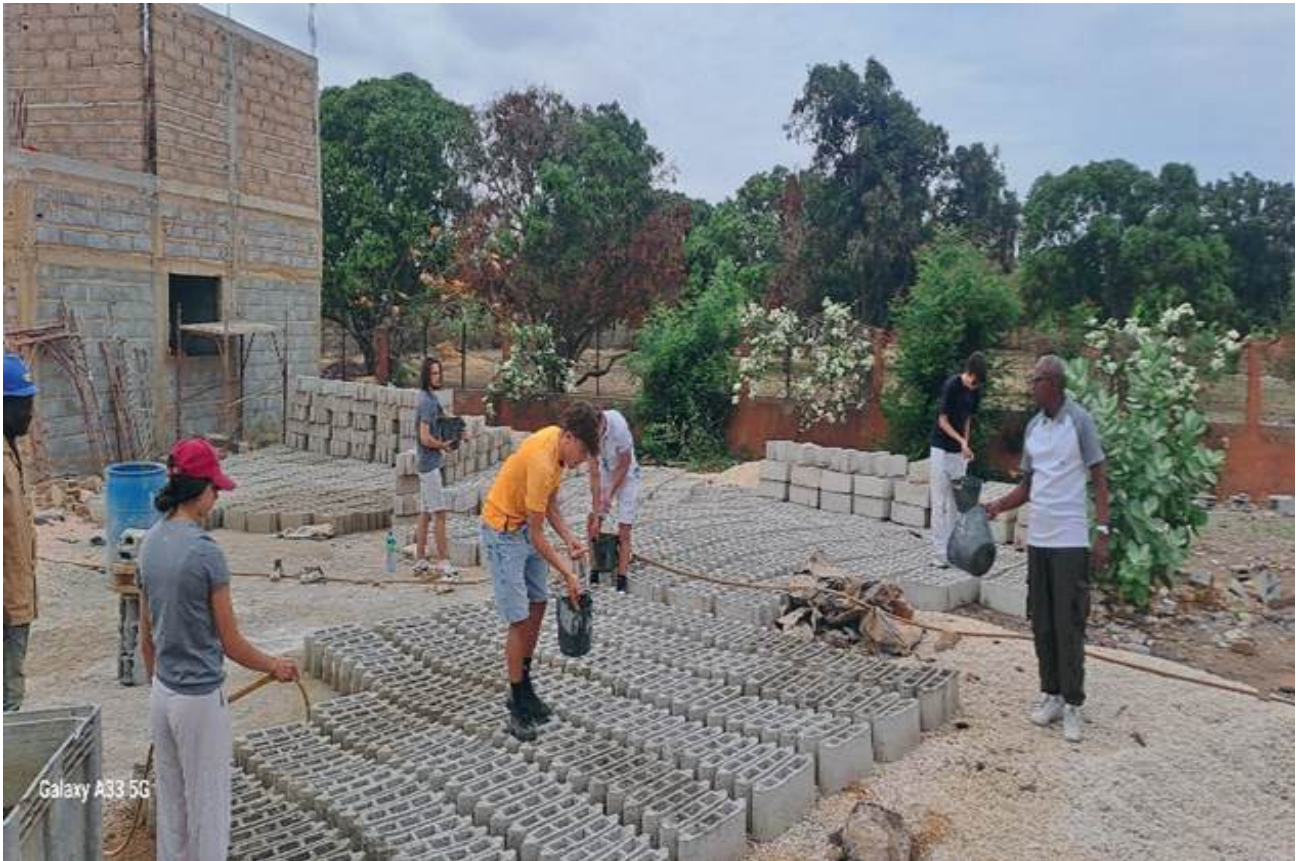
Arrosage des briques pour la construction du foyer logement avec abbé Alain, accompagnateur de l'équipe
